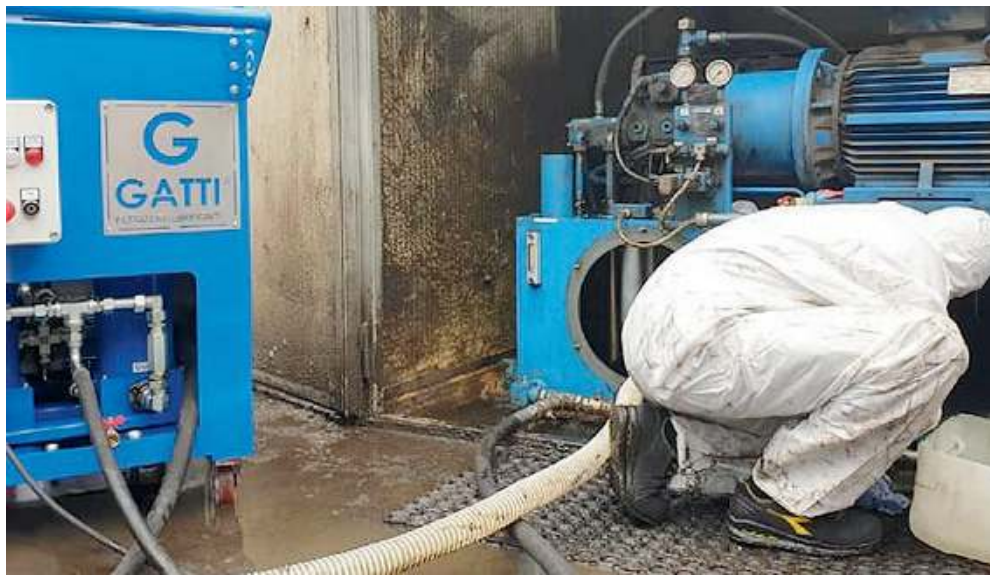
Intervento. Frequentemente vengono anche pulite le centrali da lubrifica oleodinamica
